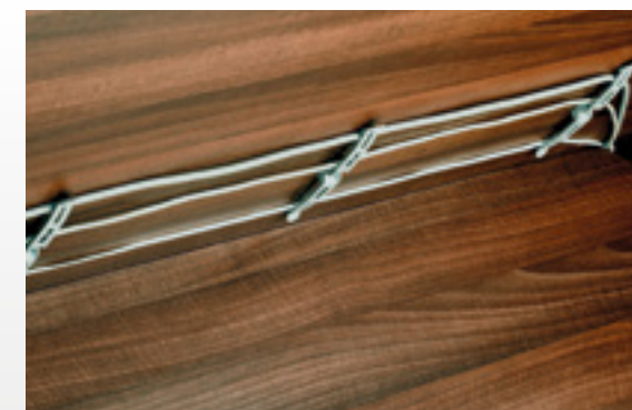
Káblové prichytky zabezpečujú praktické vedenie káblov pod pracovnou doskou
